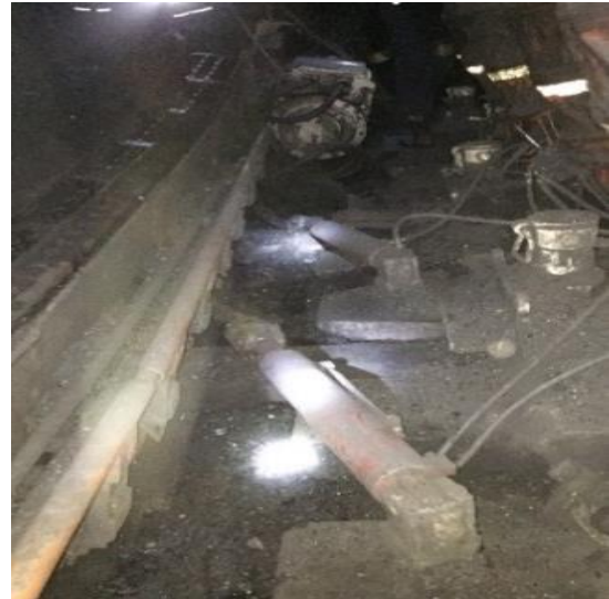
Hình 11. Hệ thống chống trôi máng cào
