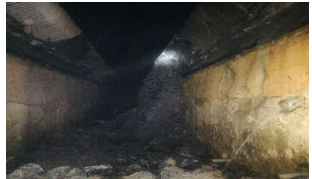
Hình 3b. Sập xỉ lò hơi tại nhà máy nhiệt điện Ung Bì ngày 12/01/2020
