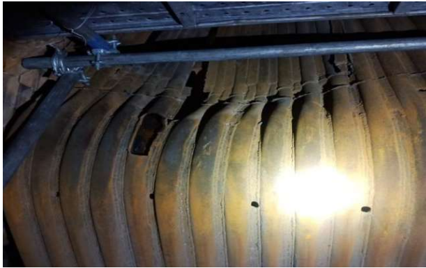
Hình 3d. Sập xỉ lò hơi tại nhà máy nhiệt điện Uông Bí ngày 08/05/2020
